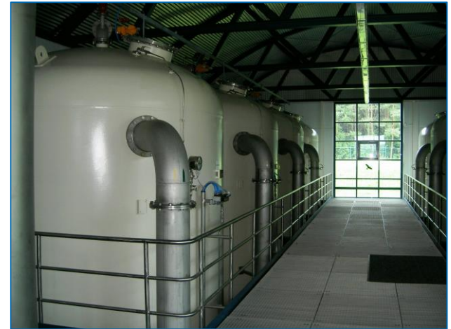
Filterhalle unserer Trinkwasseraufbereitungsanlage Bad Berka (© WZV Weimar)
