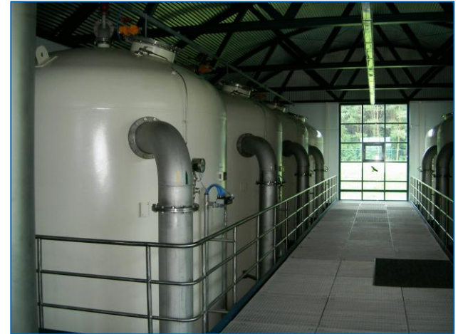
Filterhalle unserer Trinkwasseraufbereitungsanlage Bad Berka (© WZV Weimar)
